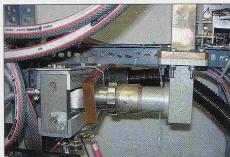
Bild 5: Übergang vom Magnetron mit koaxialem Anschluss zum Hohlwellenleiter
